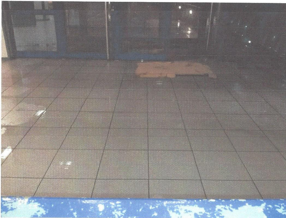
Fotografia 3: acumulació d'aigua a l'interior de la comissaria de Santa Coloma de Gramenet (2)
