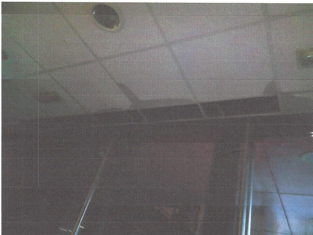
Fotografia 4: zona del sostre on s'han després les plaques a causa de l'aigua acumulada.
