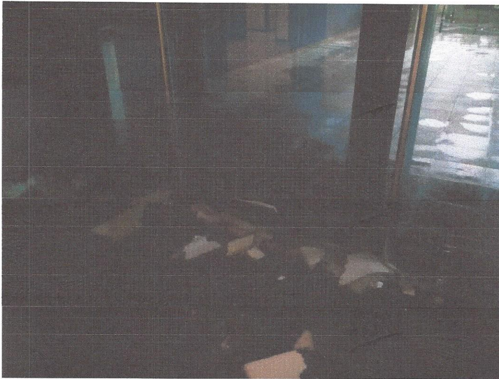
Fotografia 1: Despreniment de les plaques del sostre a causa de l'aigua acumulada al sostre.
