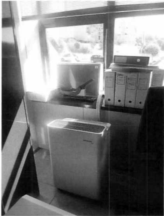
Foto 1. Màquina aire fred portàtil
