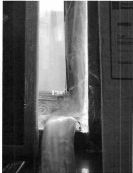
Foto 2. Finestra segellada amb cinta adhesiva
