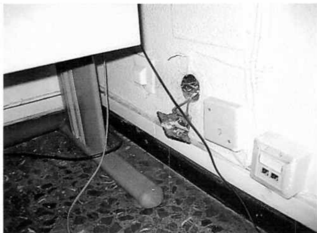
Foto 5. Endoll i cablejat
