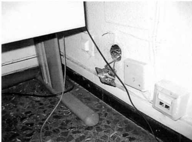
Foto 5. Endoll i cablejat
