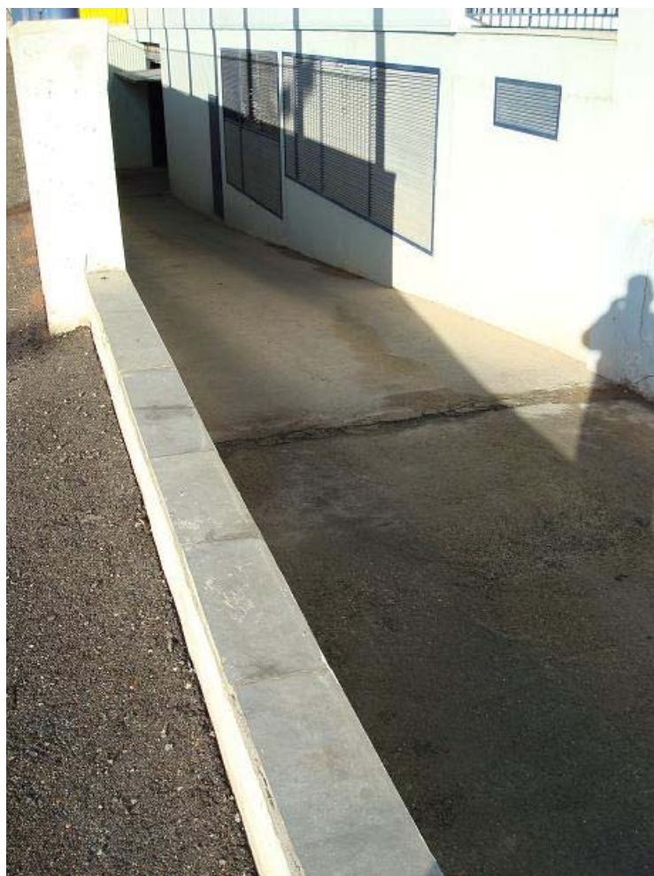
ABP TREMP. Desnivell sense protecció.
