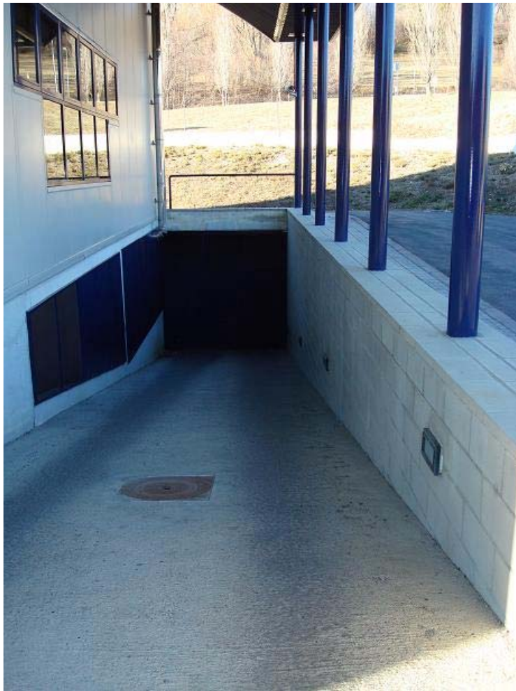
ABP PUIGCERDÀ. Rampa pàrquing i desnivells originats.
